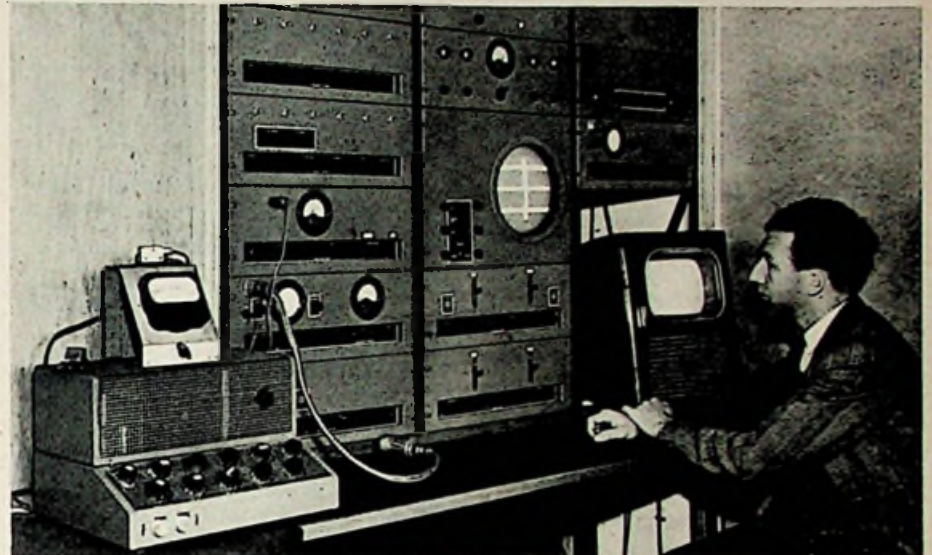
Kontrollgestell des modernen von Philips gelieferten 5-kW-Fernsehenders, der in Kopenhagen aufgestellt ist. Rechts ein Philips-Empfänger zur Überwachung des ausgestrahlten Bildes
